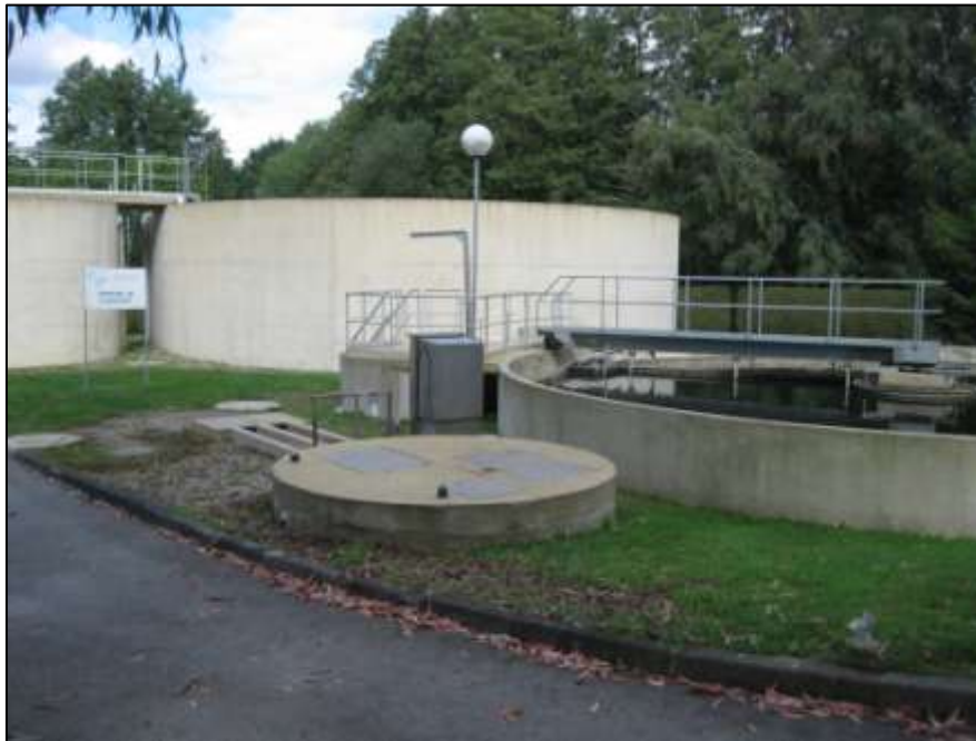
Photo 2 : Vue de la station d'épuration communale
